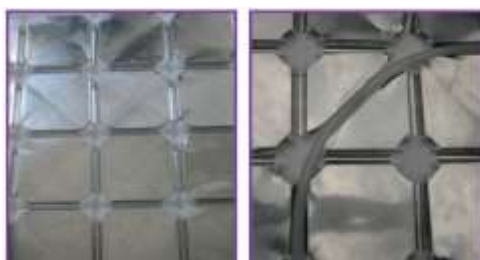
Pretranciatura della lamina di alluminio (foto a sinistra), taglio con un taglierino e passaggio del tubo (foto a destra)
