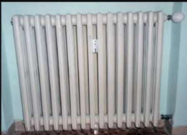
AL RADIATORE è stato montato l'attacco su cui installare il ripartitore; è già installata la testa manuale.
