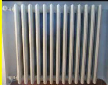
UN RADIATORE a colonne in ghisa prima dell'intervento.
